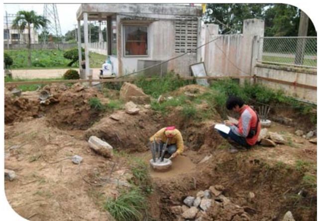
นักศึกษาทำการวิเคราะห์หาค่า ความเป็นมาตรฐานของเสาเข็ม
