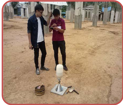
ทำการติดตั้งเครื่องมือทดสอบ เพื่อหาความหนาแน่นในสนาม
